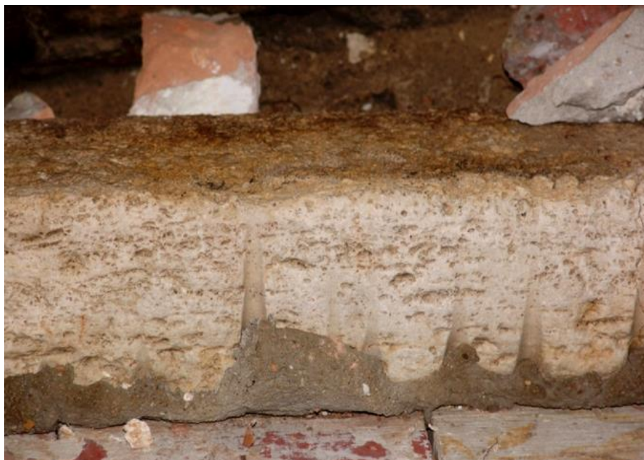
Figura 4.5 - Solcature presenti sulla parte interna della cornice superiore della vera
