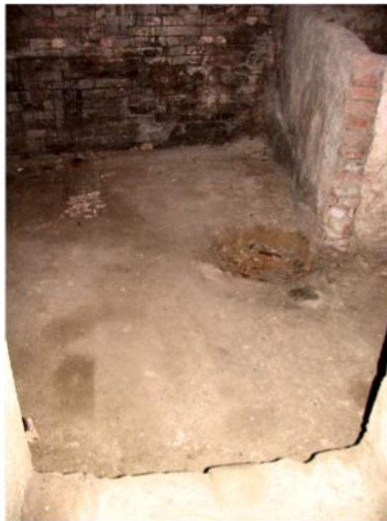
Figura 5.7 – Pozzetto di raccolta della cisterna
